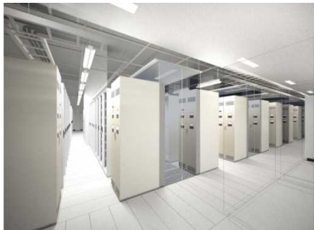
データセンター内部
